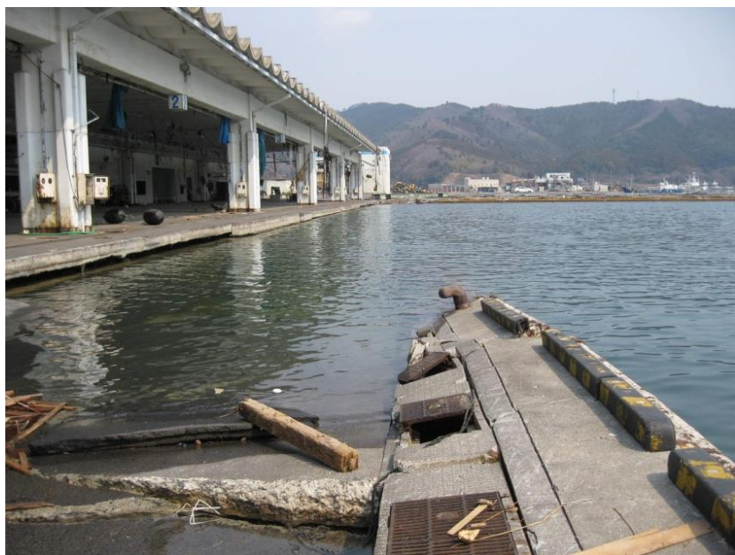
女川漁港岸壁の破壊と建屋部分の地盤沈下
