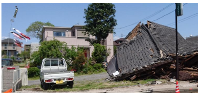
倒壊をまぬがれた家屋と倒壊した家屋
