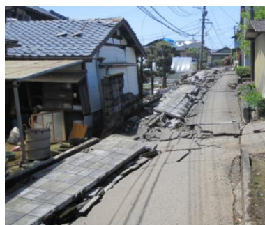
ブロック塀の倒壊
