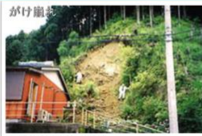
県内でのがけ崩れ
