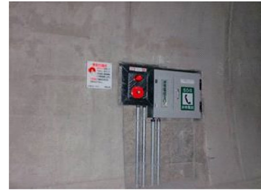
トンネル内防災設備
