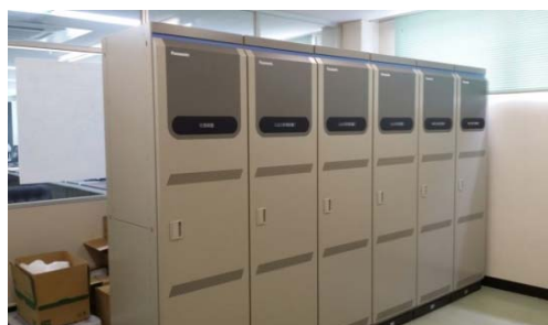
ダム管理用制御処理設備更新
