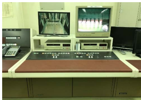
CCTV設備（監視装置）
