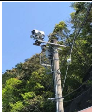
CCTV設備（堤体上流）
