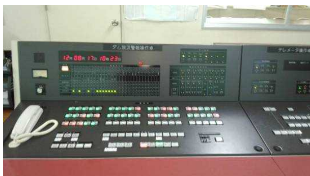
放流警報装置
